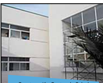
Construcción Centro de Salud Familiar Ocoa y Posta de Salud Rural el Romeral, Hijuelas construidos
